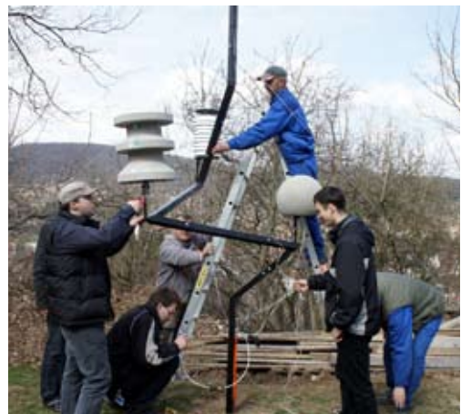
Helyspecifikus tervezést segítő mérőrendszer telepítés közben
